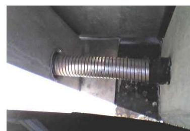
EPIS EP管 露出部
